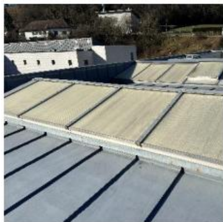
Img. 13 : Fenêtre de toit en polycarbonate, opacification due à l'exposition aux UVs
