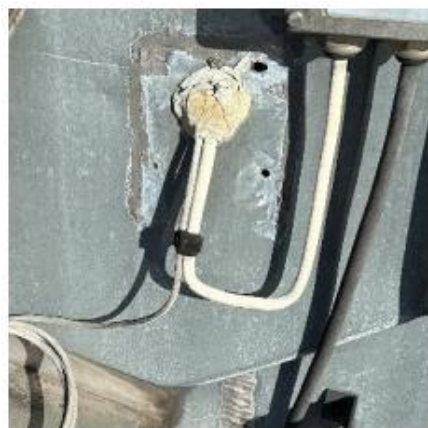
Img. 12 : Sortie de câble avec capotage manquant
