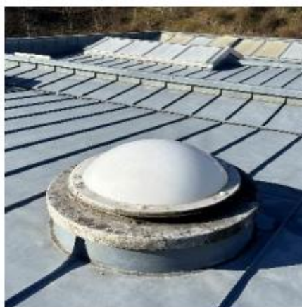
Img. 15 : Fenêtre de toit en polycarbonate, opacification due à l'exposition aux UVs
