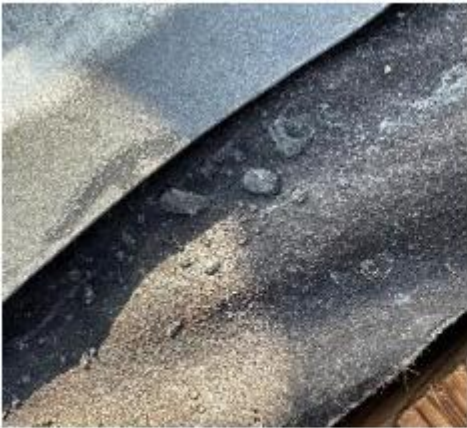
Img. 1 : Présence d'eau sous la couverture zinc lors des sondages
