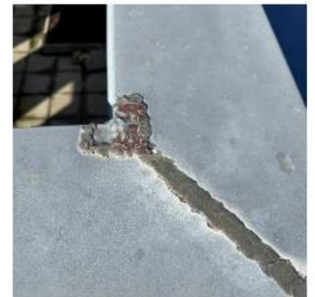
Img. 5 : Réparation de raccord, présence de nouvelles fissurations
