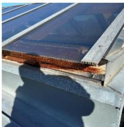
Img. 14 : Dégradation d'une fenêtre de toit, habillage manquant et présence d'humidité dans le bois
