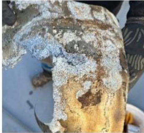
Img. 2 : Corrosion en sous face de la couverture zinc révélée lors des sondages
