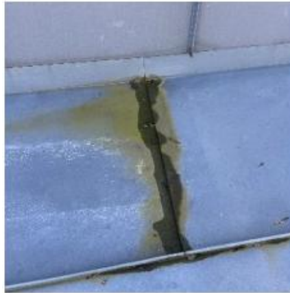
Img. 3 : Remontée d'eau au droit d'un raccord de couverture
