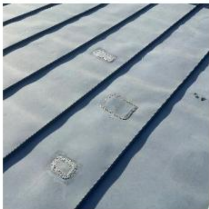
Img. 6 : Présence de nombreuses réfections ponctuelles
